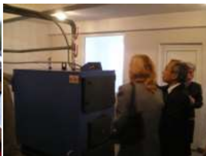
新たに整備した暖房システム（燃焼機）
